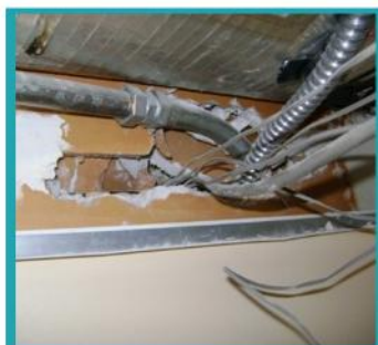
Entretecho con puntos de infiltración identificados.
